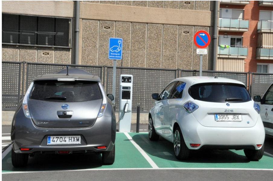
Figura 94. Punts de recàrrega per a vehicles elèctrics
